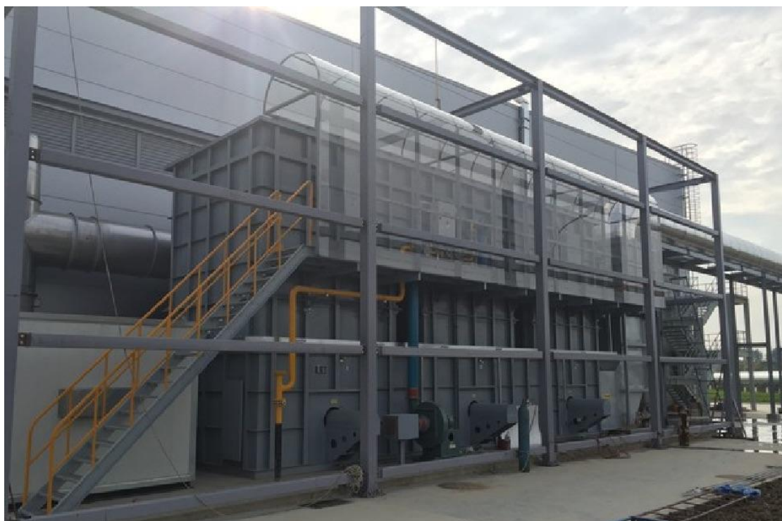
图 6.1-5 RTO 设备实物照片
